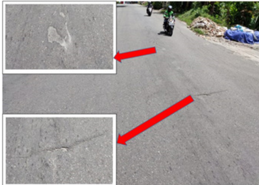
Gambar 2. Kondisi Retak dan Berlubang Jalan J. Syaranamual
