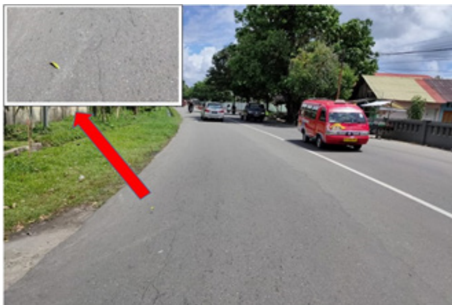
Gambar 3. Kondisi Retak Jalan Laksdya Leo Wattimena
