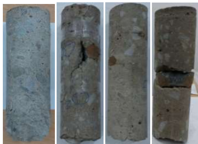
Gambar 6. Sampel Beton hasil pengambilan pada struktur silo kerucut
