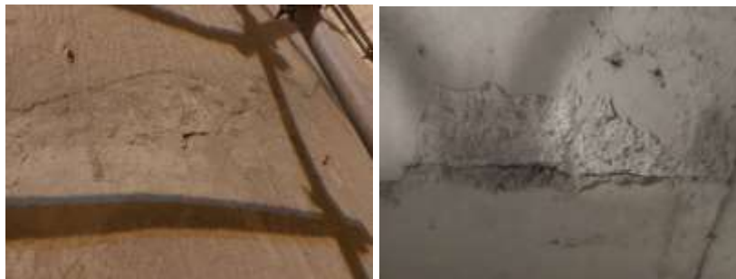
Gambar 2. Visual Kerusakan Sisi Atas Pelat Silo Kerucut
