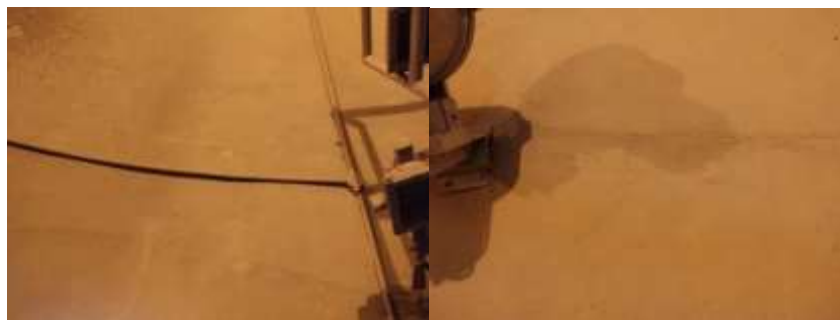
Gambar 3. Visual Kerusakan Sisi Bawah Pelat Silo Kerucut
