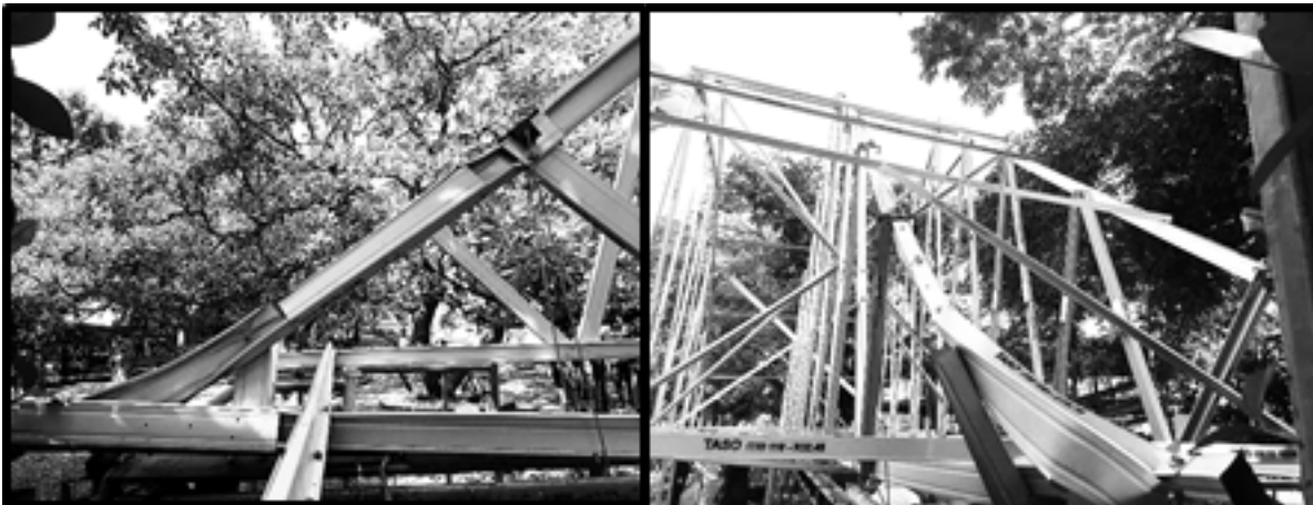
Gambar 10. Kerusakan pada Kuda-Kuda
